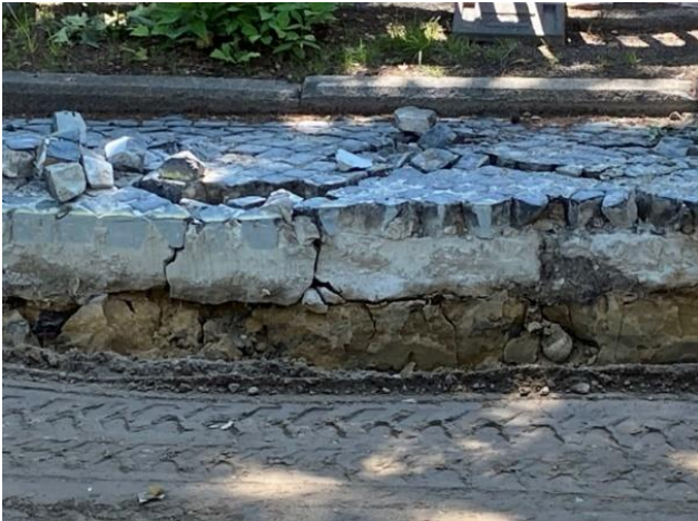
Abb.: Betondecke unter dem Pflaster. Mittlerweile ist das Pflaster bis über die Höhe Markgrafenstraße vollständig entfernt (Quelle: Bürgerverein)
